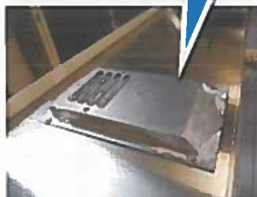
2 aérateurs dans le toit
