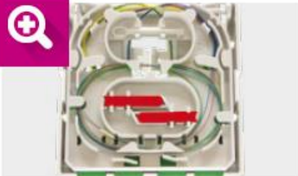
Accès lochage fibre Facilité par ouverture de la zone de lochage
